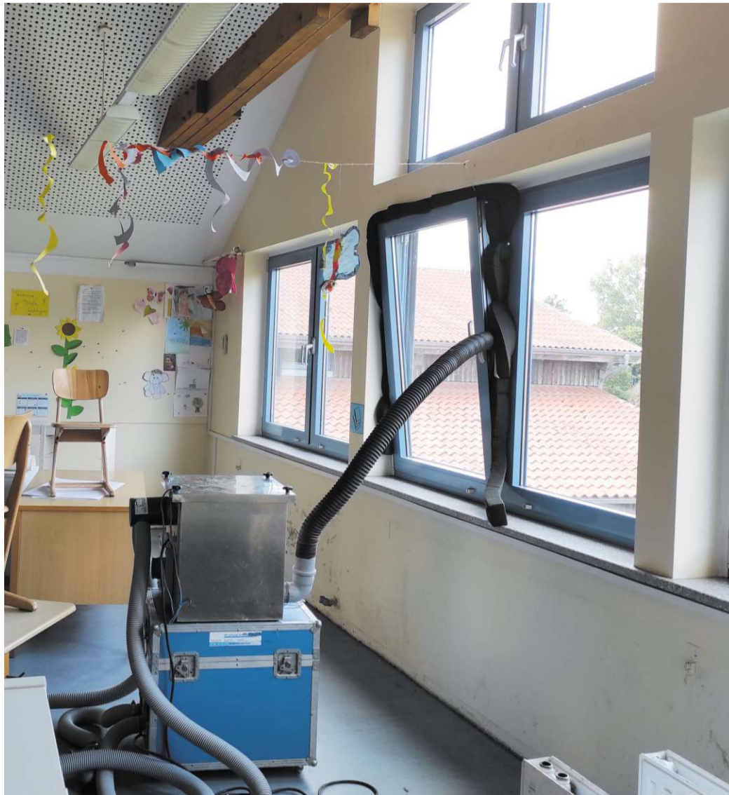
Die Schläuche enden in einem großen Schlauch am Fenster: In den oberen Klassenzimmern sind vor allem die Böden und Leisten stark vom Wasser betroffen. Fotos: Scheele
